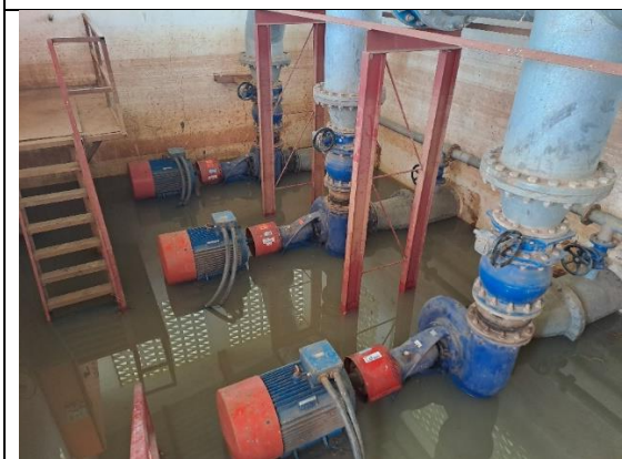
Estação de Bombagem alagada
