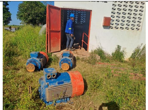
Motores fora da casa das Bombas
