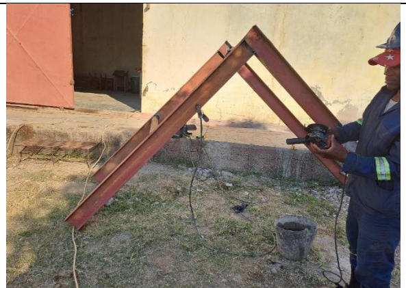
Suporte para remoção das Bombas
